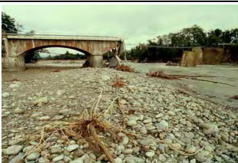
Fig. 2.45 - In occasione delle più intense manifestazioni idrometeorologiche si possono verificare gravi fenomeni di dissesto idrogeologico. In questa immagine si osserva un ponte autostradale sul torrente Malone (in provincia di Torino) in gran parte "spazzato" dall'alluvione del 1992.
